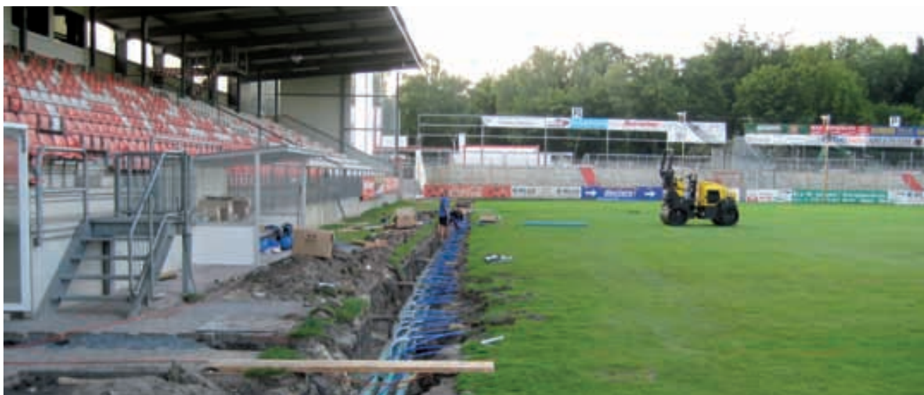
Стадион Werse в г. Ален - реализован трубопроводной системой climatherm для отопления, охлаждения, кондиционирования фирмы «aquatherm».
